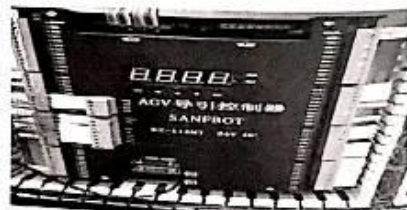
图2 AGV系统电气仓主控单元
